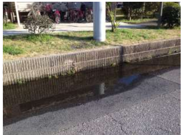
(排水の悪い市道04-016号線の側溝)
